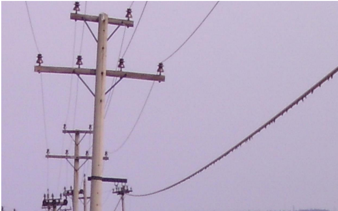
Рисунок 1.1 – Электротермическая деградация ВОЛС на линии СЦБ
