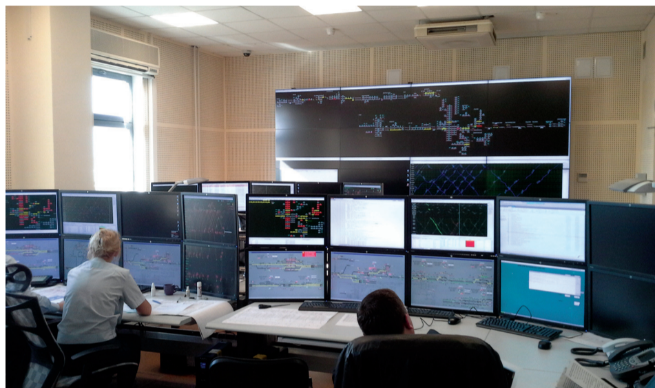
В пункте управления размещены три автоматизированных рабочих места: поездных диспетчеров, АРМ старшего диспетчера, а также АРМы дежурного технического персонала
